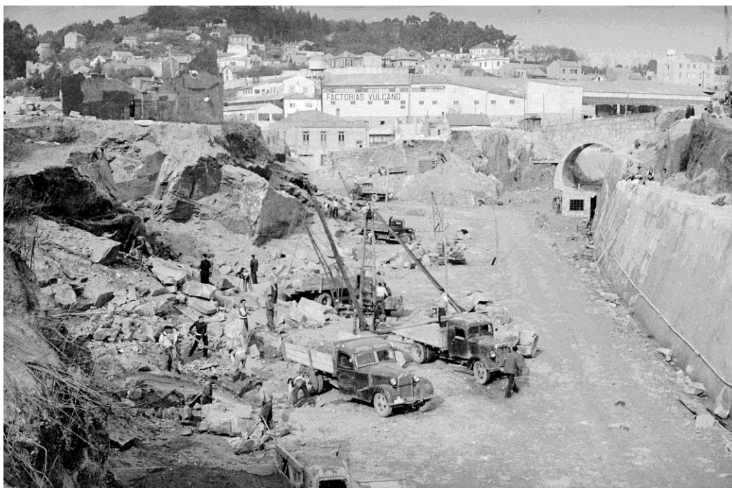
Arriba: Construcción de la trinchera del tramo de vía que viene desde Guixar, paralelo a la calle Julián Estévez, y que pasa bajo ese paso elevado tras el que se abre el túnel de A Guía. Fotografía: Pacheco, 1951. Fondo fotográfico de Factorías Vulcano . Ref. 4/1951
